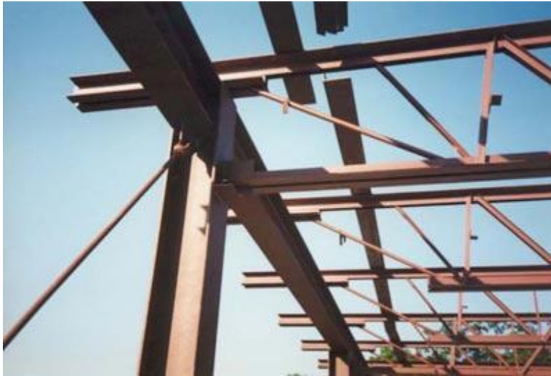
Figura 13.- Ejemplo de estructura donde se aprecian algunos de sus elementos (Shreeji Steel).
